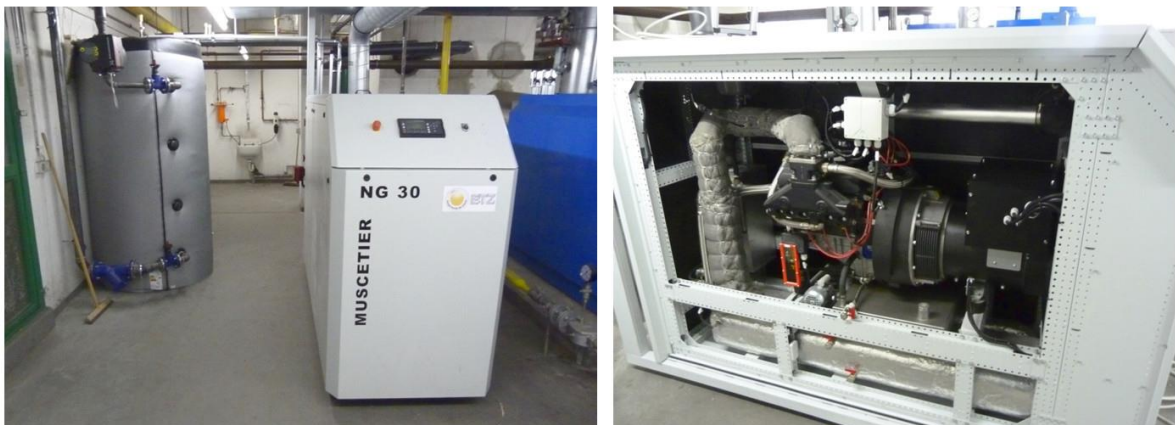
Abbildung 25: Blockheizkraftwerk im Erasmus-von-Rotterdam Gymnasium
