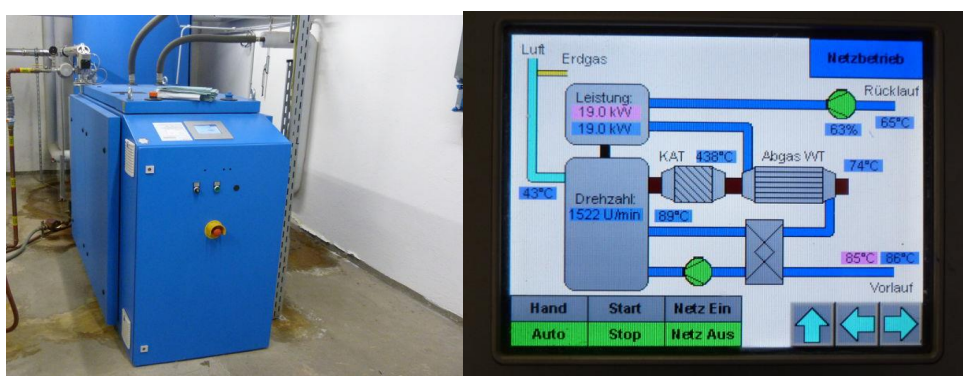
Abbildung 21: installiertes BHKW und Betriebsdisplay in der PRIMUS-Schule
