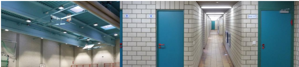
Abbildung 27: neue Hallenbeleuchtung in der Turnhalle des Erasmus-von-Rotterdam Gymnasiums
