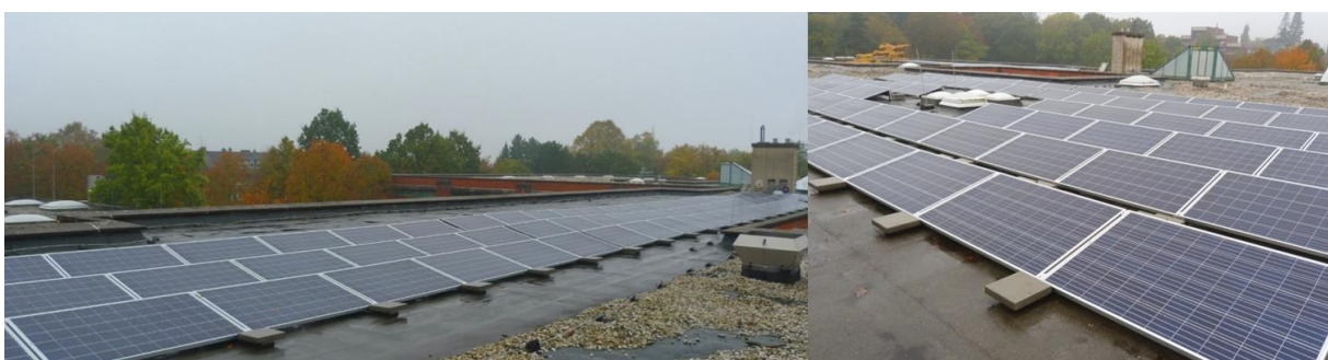
Abbildung 24: Photovoltaik-Anlage auf dem Flachdach des Erasmus-von-Rotterdam Gymnasiums
